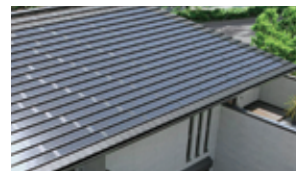
太阳能发电系统 瓦屋顶一体型
