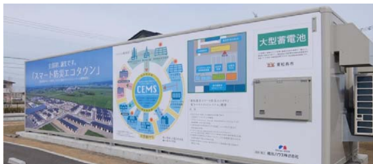
タウンの中心に設置された大型蓄電池
