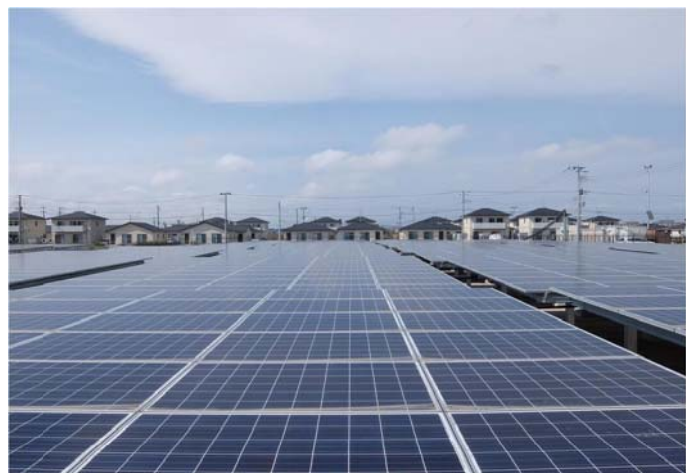
防災調整池に設置された太陽光発電システム
