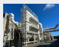
木工集塵機 (高効率機器への変更)
