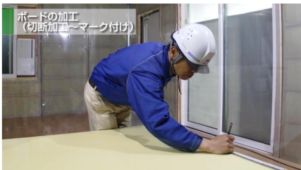
③取得した下地寸法にしたがって、施工従事者が石膏ボードを切断・加工
