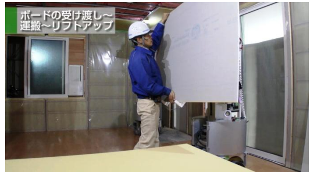
④加工した石膏ボードを「Carry」に施工従事者が受け渡す
