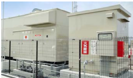
バイオディーゼル非常用発電機(500kVA)
