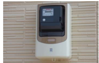
スマートメーター
