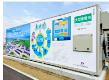
大型蓄電池(480kWh)
