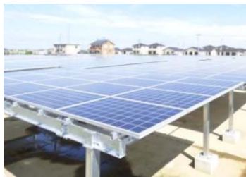
防災調整池 PV 400kW
