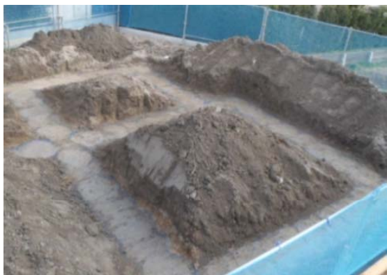
戸建住宅での適用事例
