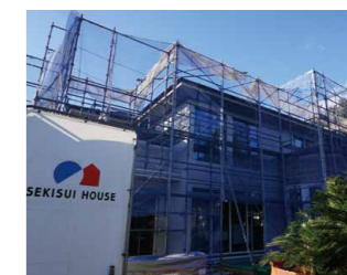
HED-Netの導入工事が進む積水ハウスの新築戸建住宅 (2020年11月撮影 千葉県松戸市)
