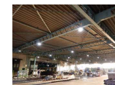
照明のLED化(鉄検査場)
