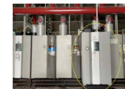
最新式高効率タイプボイラー
