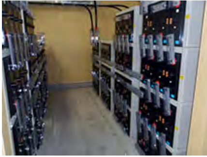
大型蓄電池（改修後）
