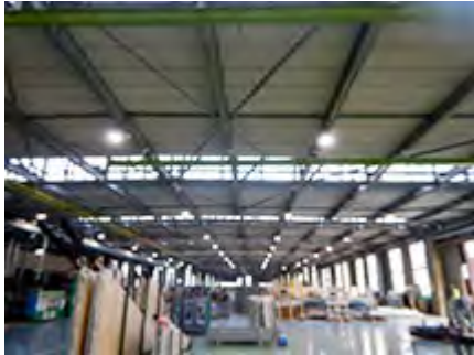
照明のLED化（第1木工場）
