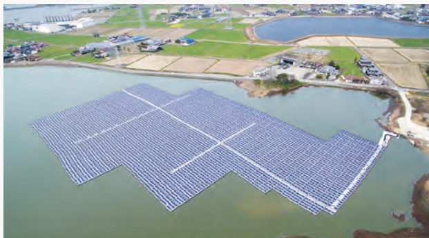
水上ソーラーシステム
