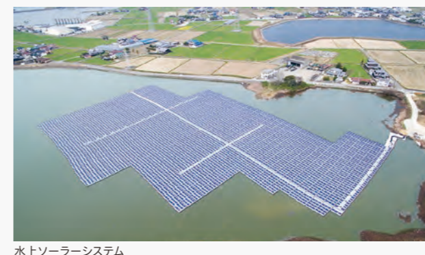
水上ソーラーシステム
