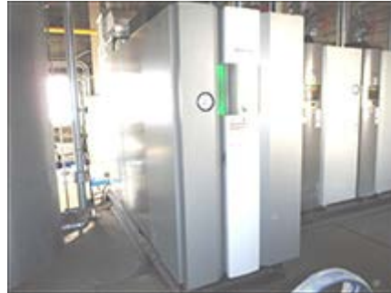
高効率ボイラーの導入
