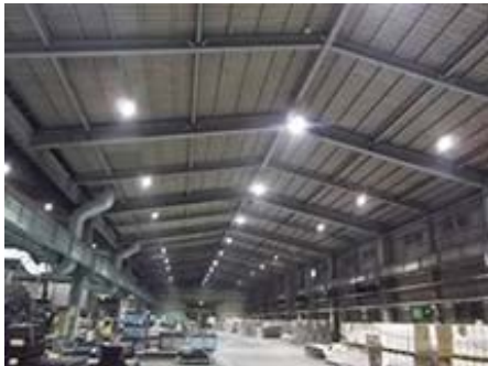
照明のLED化(第4鉄工場)
