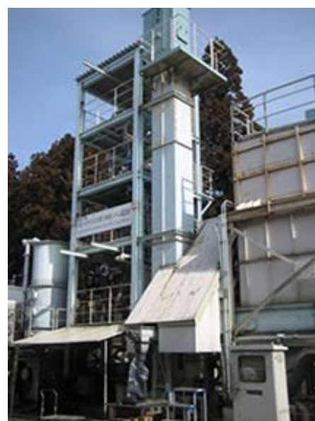
木質バイオマスプラント外観
