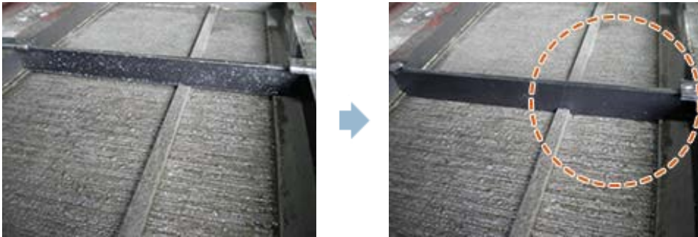
目地上仕切り改造によるコンクリート漏れ対策
