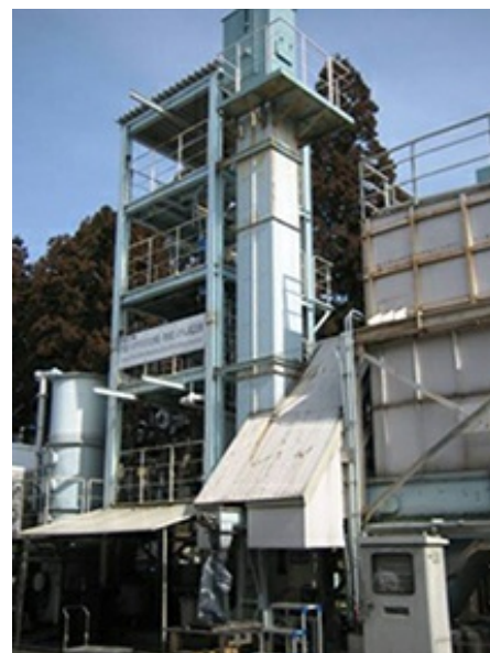
木質バイオマスプラント外観
