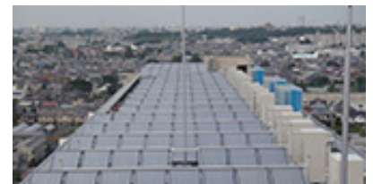
屋上太陽熱パネル
