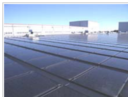
工場屋根への設置例
