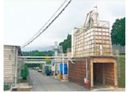
プリケットから可燃性ガスを抽出し、自社工場に電力と熱を供給
