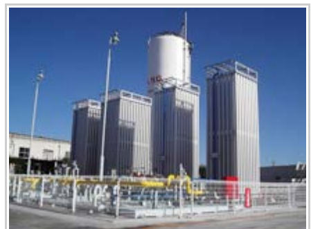
LNG貯蔵施設
