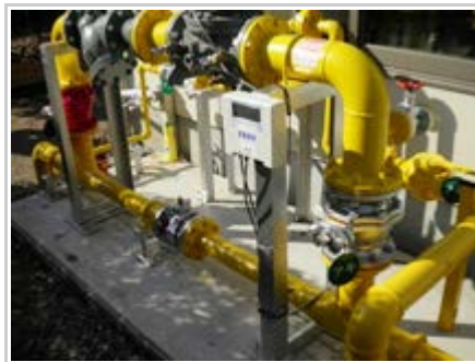
都市ガスメインメーター
