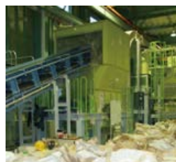
栗東資源循環センターの リサイクル材製造ライン
