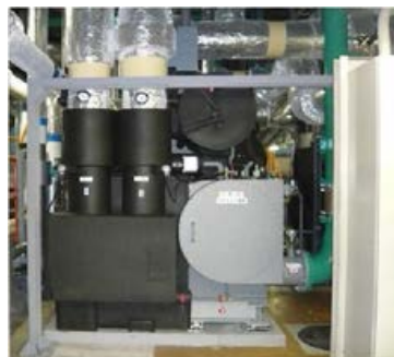
氷蓄熱式冷凍機
