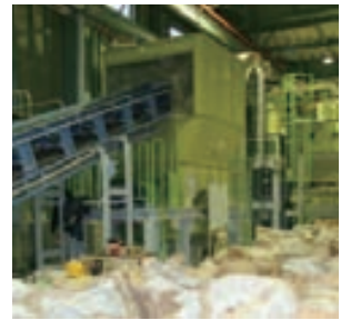
栗東資源循環センターのリサイクル材 製造ライン
